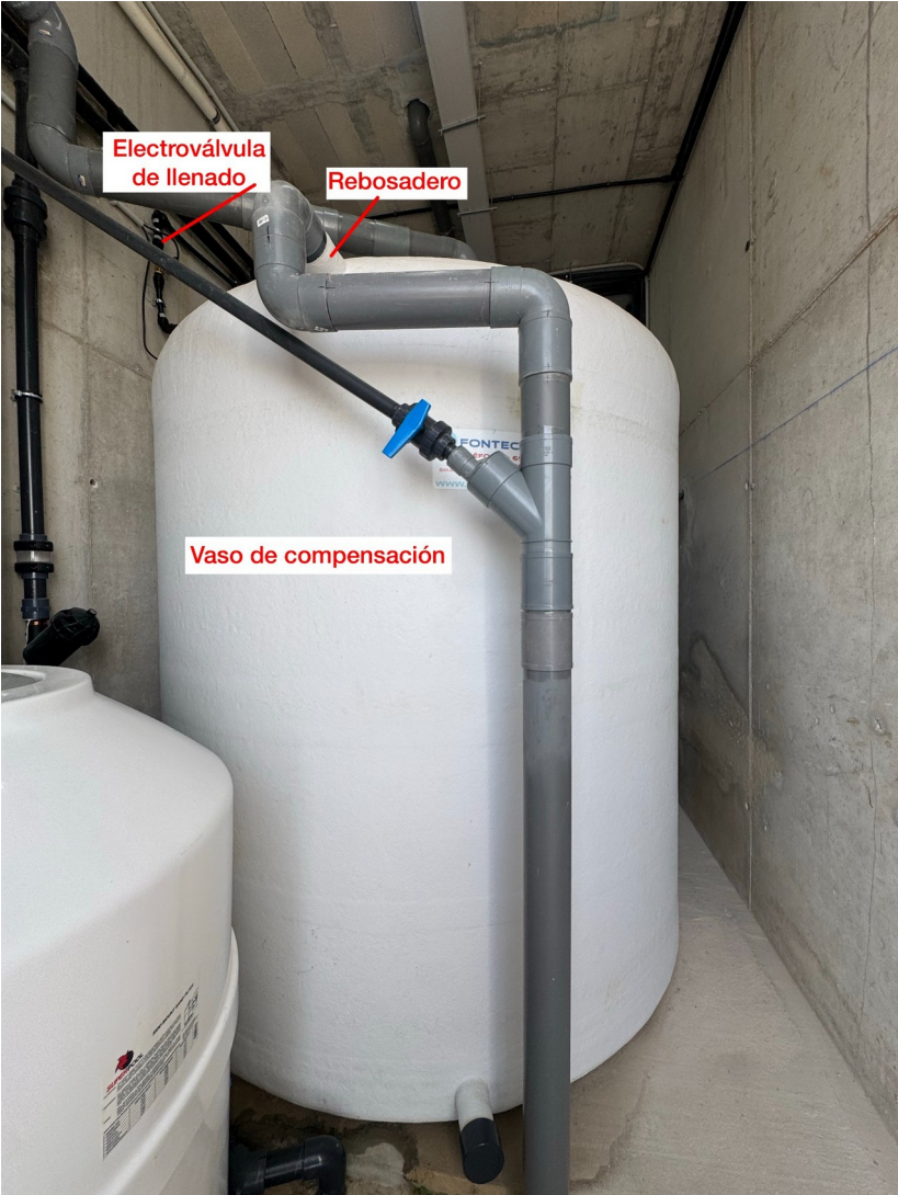
Fotografía 2. Depósito de compensación PRFV de 12.000 litros, con tuberías de entrada desde canal desbordante, rebosadero, llenado automático y conexiones auxiliares.
