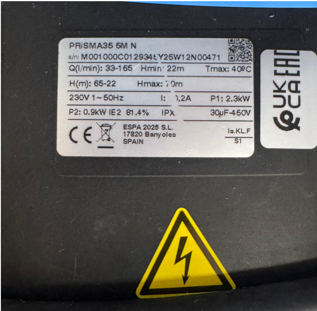
Fotografía 3. Placa de características de la bomba ESPA Prisma35 5M N instalada.
