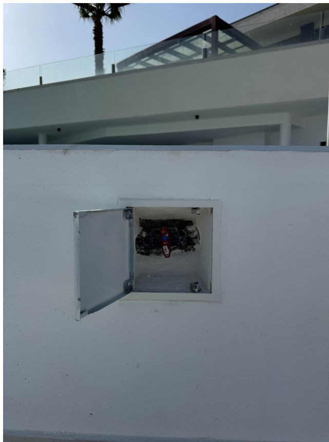
Fotografía 7. Llave manual de llenado situada en el lateral de la bañera caliente, dentro de registro protegido.
