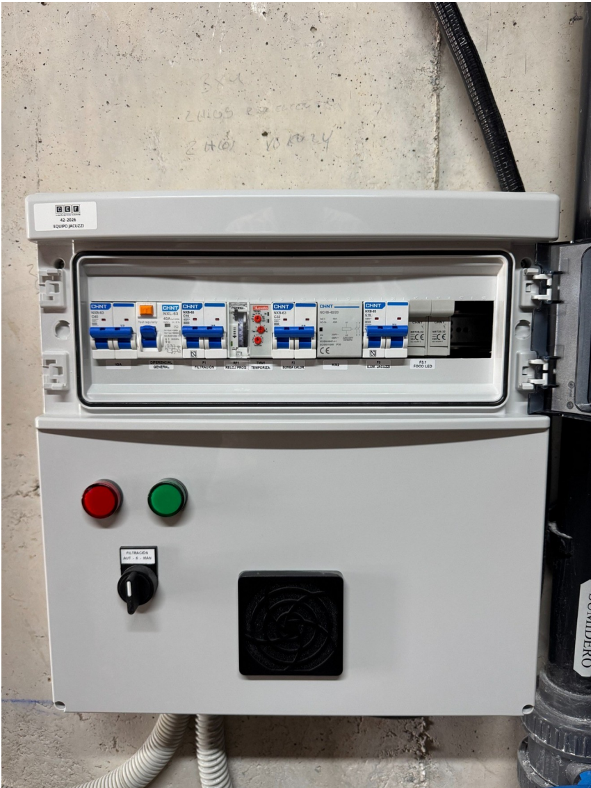
Fotografía 5. Cuadro de maniobra de la bañera caliente con selector FILTRACIÓN AUTO - 0 - MAN.
