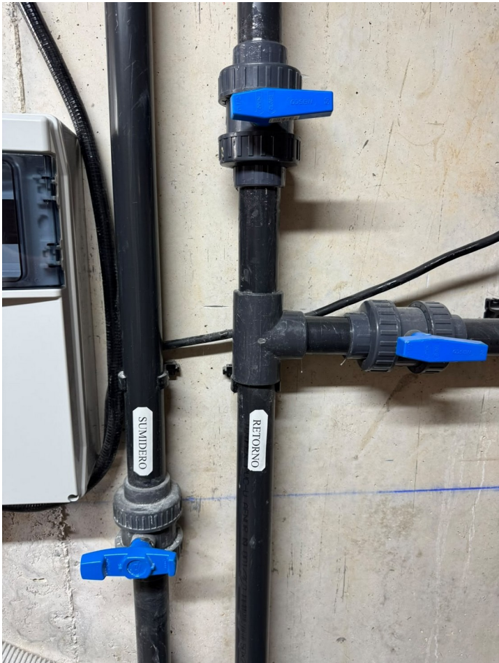
Fotografía 4. Identificación de las conducciones de SUMIDERO y RETORNO y referencia visual de las posiciones de las válvulas.
