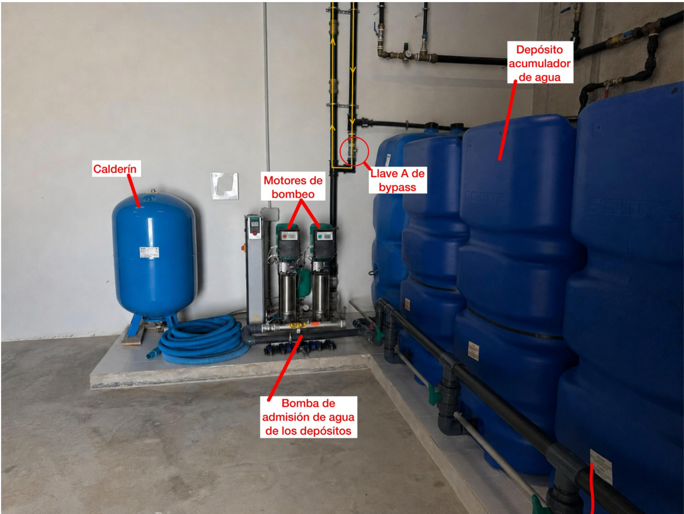
Fotografía 1. Vista general señalizada del grupo de presión, calderín, batería de depósitos y llave A de bypass. Las flechas amarillas representan el recorrido excepcional del agua cuando se abre el bypass.
