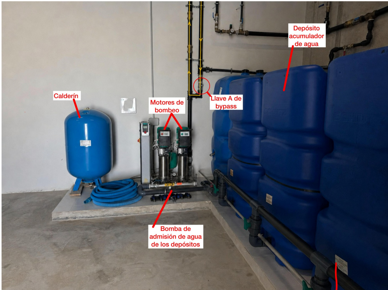
Fotografía general señalizada del grupo de presión, depósitos de acumulación, calderín y bypass de suministro.
