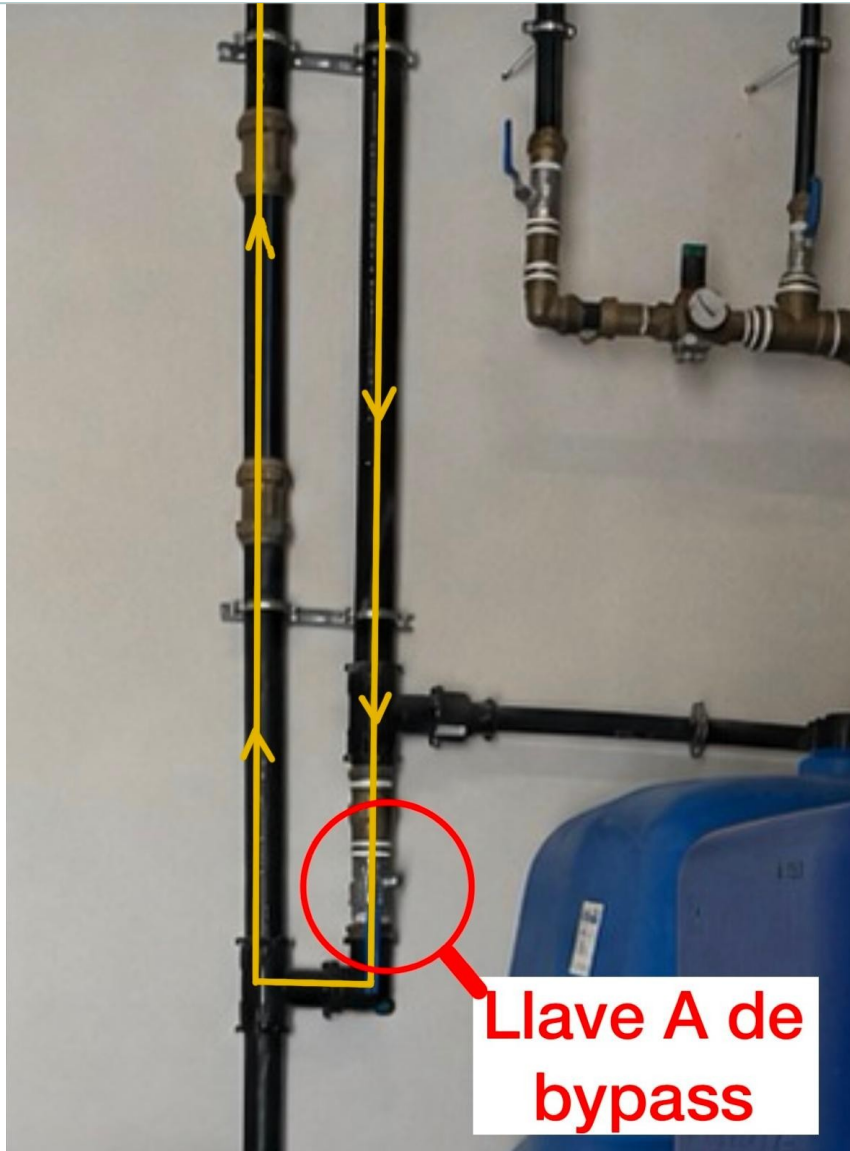
Fotografía 2. Detalle de la llave A de bypass. Las flechas amarillas indican el sentido de circulación del agua cuando se habilita la alimentación directa desde la red pública.
